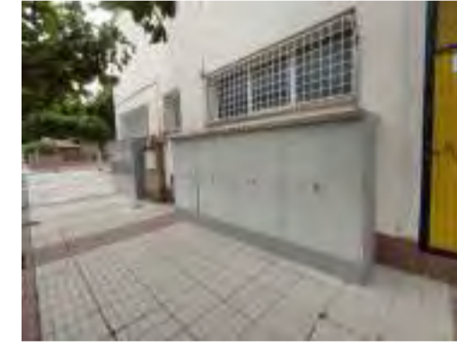
VISTA 07. CUADROS ELÉCTRICOS PABELLÓN POLIDEPORTIVO
